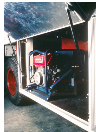
Генератор и компрессор в отапливаемой нижней части кузова
